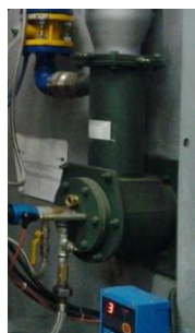
Zabudowa palnika na ścianie pieca
