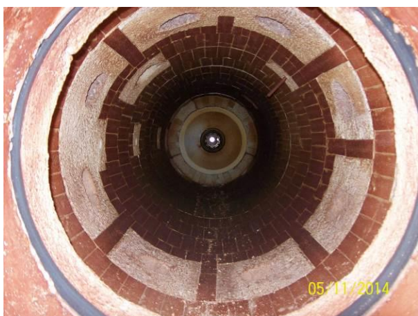
Komora spalania z kształtką palnikową
