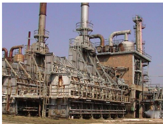
Rys. 2 Piec do syntezy CS 2 przed modernizacją
