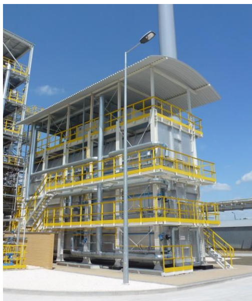
Rys.1 Piec do odparowania ciekłej siarki
