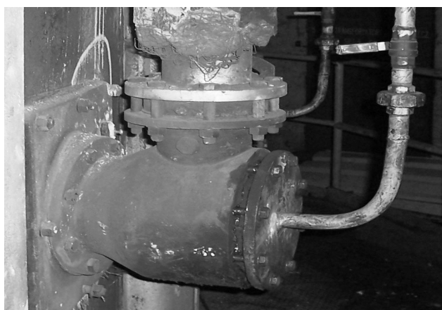
Rys. 1. Palnik wirowy w ścianie pieca z obrotowym trzonem o średnicy podziałowej 6, 5 m
