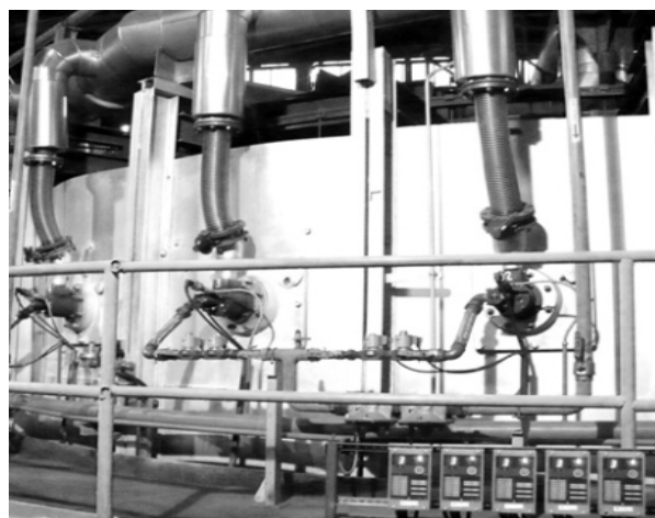
Rys. 2. System grzewczy pieca z obrotowym trzonem o średnicy podziałowej 6, 5 m po modernizacji
