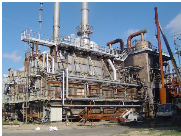
Rys. 1 Piec do syntezy CS 2 po modernizacji
