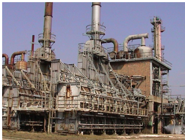
Rys. 2 Piec do syntezy CS 2 przed modernizacją
