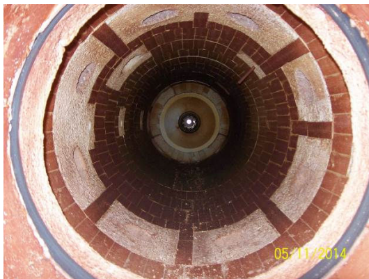
Komora spalania z kształtką palnikową
