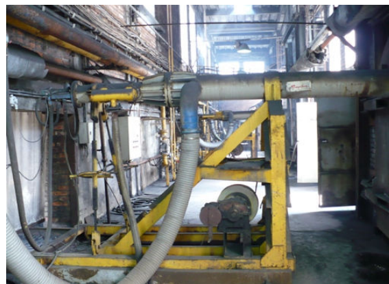
Fot. 3 Układ jezdny palnika 7 MW
