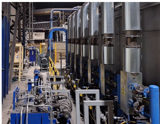
Rys.3 Widok pieca komorowego – tył z systemem palników rekuperacyjnych RPG oraz agregatem hydraulicznym napędu i docisku bramy
